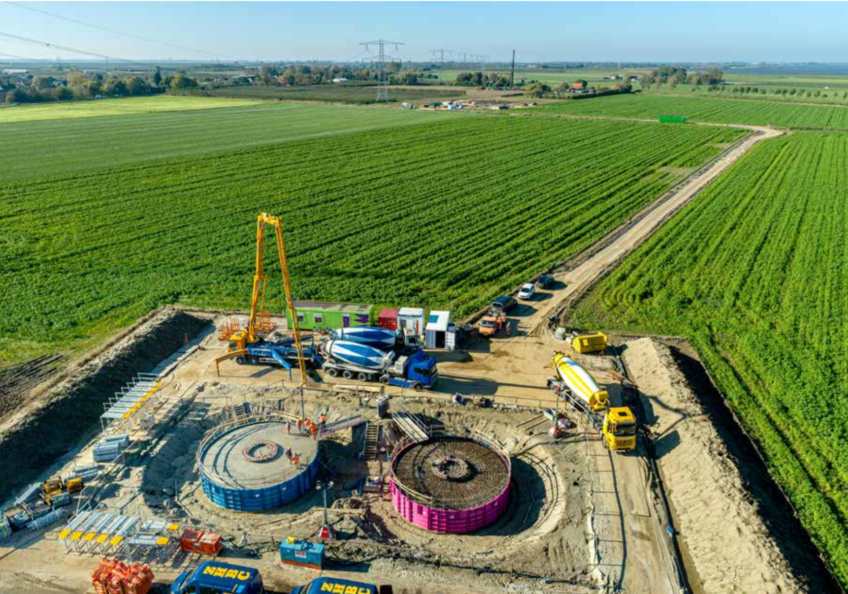
Mobilis is verantwoordelijk voor het betonwerk, de funderingswerkzaamheden worden uitgevoerd door Voorbij en Terracon.
